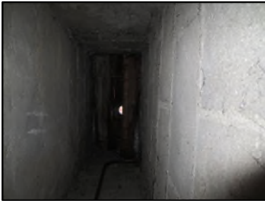
Photo N° 604 AMIANTE CIMENT -- Gaine technique 4 Gaines & coffres verticaux Ventilation haute (Fibres- ciment)
